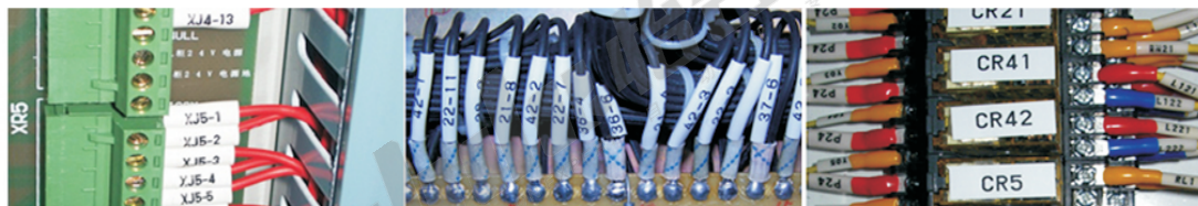
控制室线路标识
